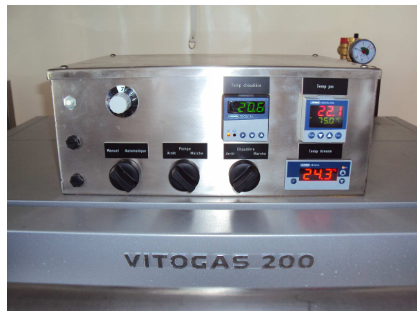
Coffret électrique avec réglage auto. T° sortie jus
